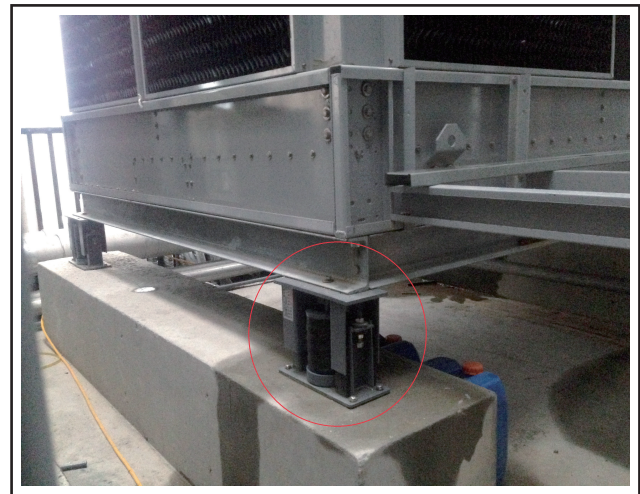
水塔安裝抗震型彈簧橡膠模鑄型避振器
