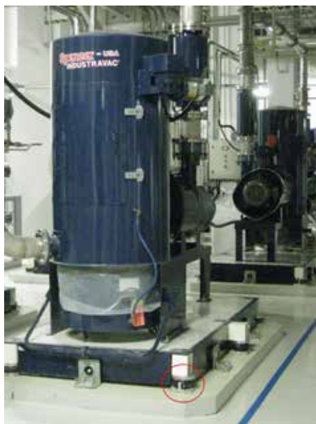
真空機安裝YS-K氣墊式避振器
