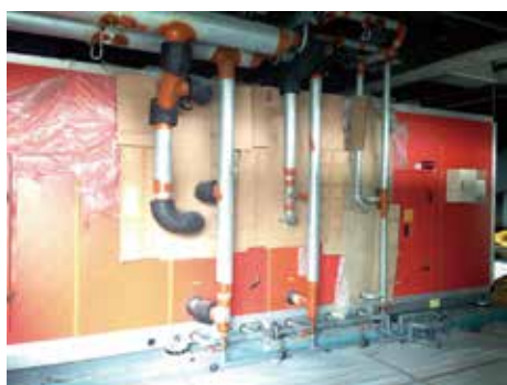
空調箱安裝YS-K氣墊式避振器
