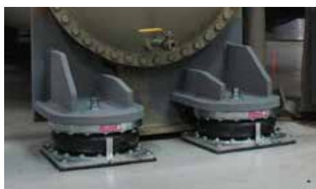
冰水主機安裝YS-K氣墊式避振器
