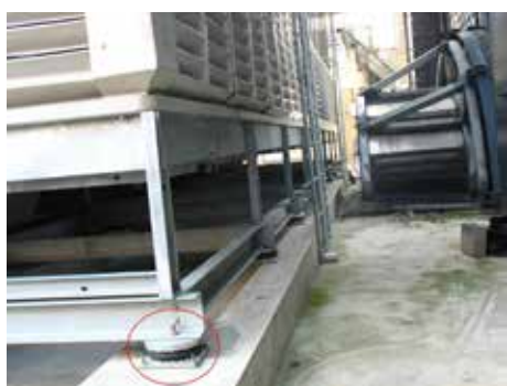
水塔安裝YS-K氣墊式避振器
