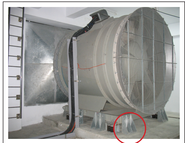
YS-270EA 安裝於雪山隧道大型風機
