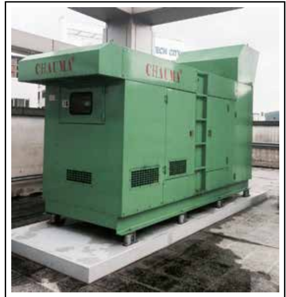
發電機安裝YS-B彈簧式避振器
