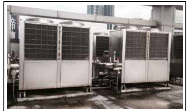
氣冷主機安裝YS-B彈簧式避振器
