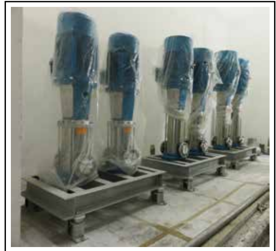
揚水泵安裝YS-B彈簧式避振器
