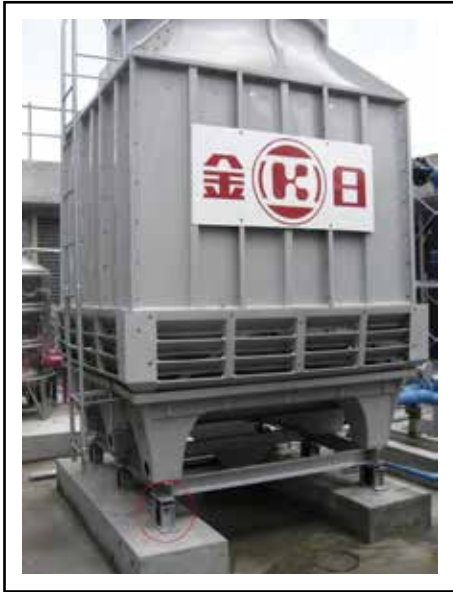
冷卻水塔安裝YS-A彈簧式避振器
