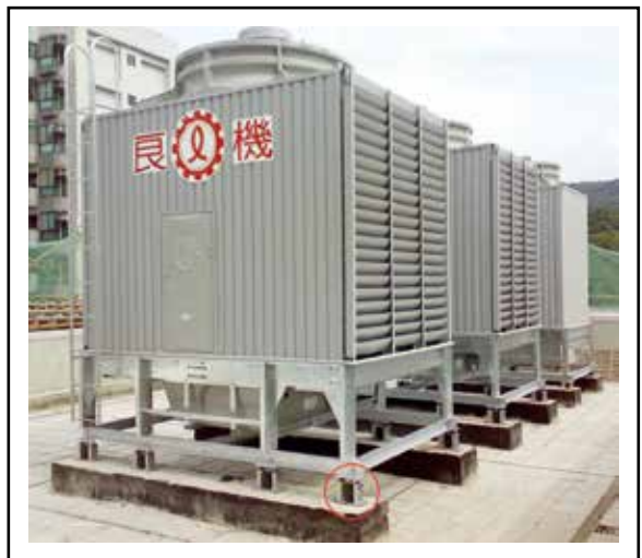
冷卻水塔安裝YS-A彈簧式避振器
