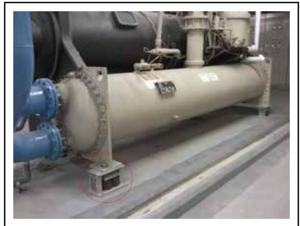
冰水主機安裝YS-A彈簧式避振器
