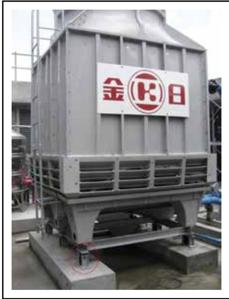
冷卻水塔安裝YS-A彈簧式避振器
